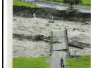
Die Brücke wurde komplett zerstört.
