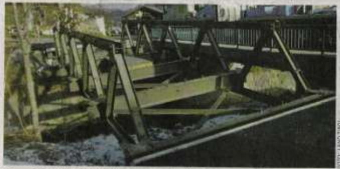
Derzeit ist die Behelfsbrücke des Landes beim Brückenneubau in der Kelchsau im Einsatz.
