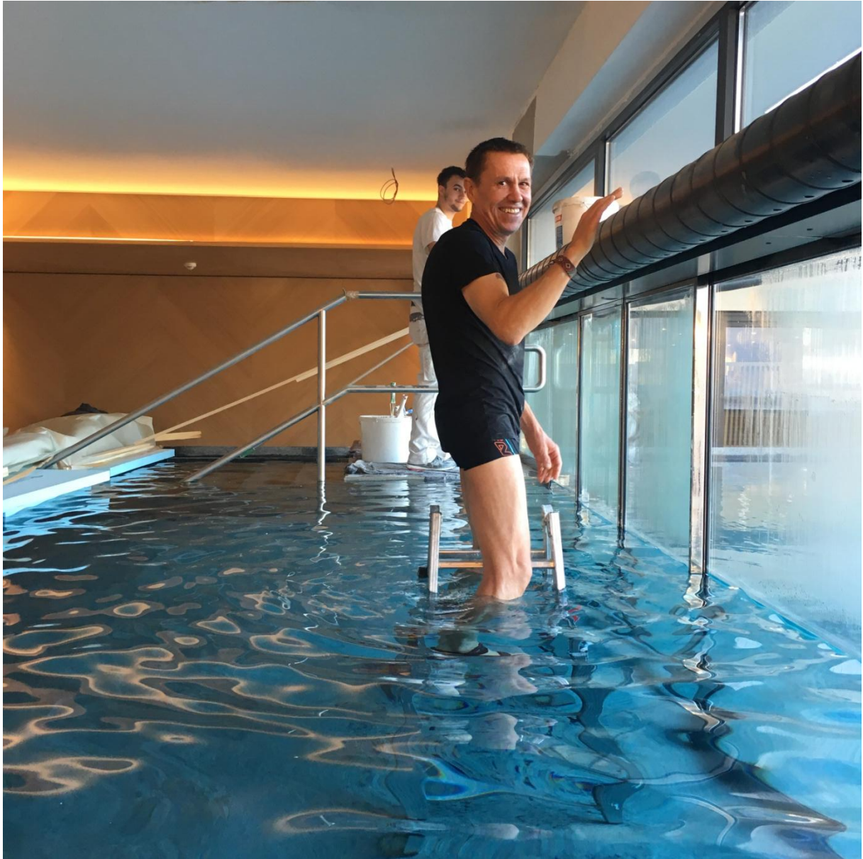
Was unsere Handwerker alles unternehmen, um die Fertigstellung der Hoteleinrichtungen nicht zu verzögern; im Vordergrund Malermeister Stefan Decker
